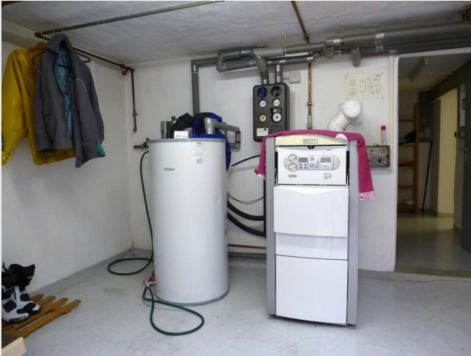
Gas Heizung mit Boiler
